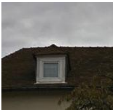
Pose de menuiseries en rénovation réduisant le clair de vitrage et dénaturant la lucarne ancienne
