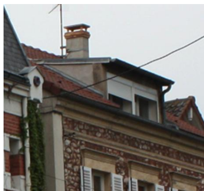
Lucarne récente dont la volumétrie dénature le bâti ancien
