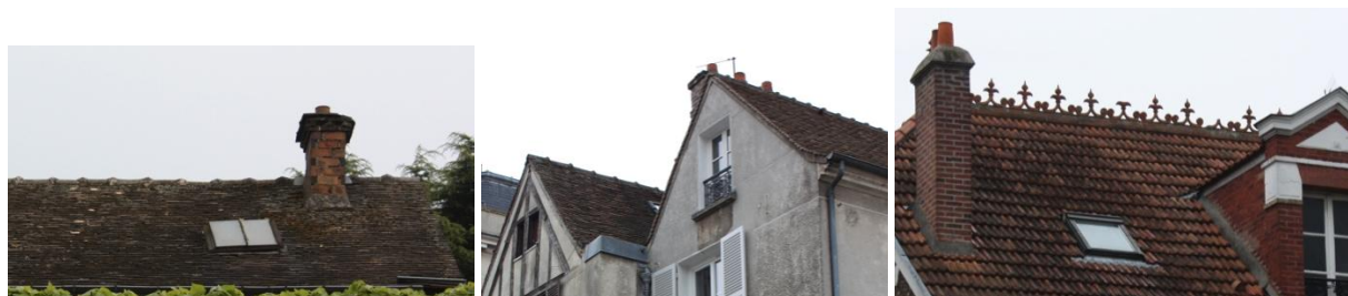
Les différents types de toiture en tuile plate de petit moule ou tuile mécanique
