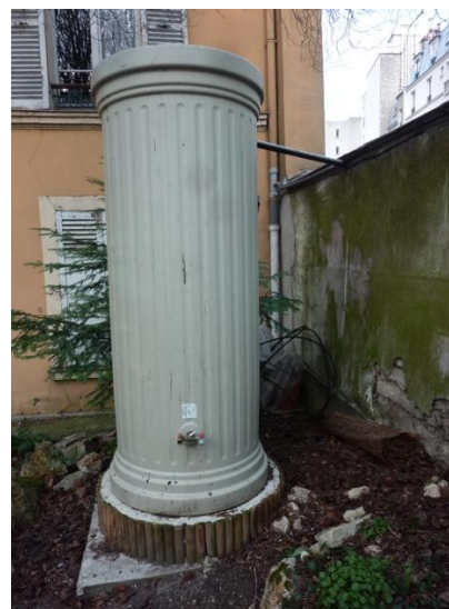
Exemple de citerne extérieure raccordée directement sur la descente d'eaux pluviales
