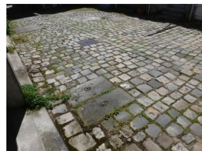
Exemple de maintien des pavés et des dalles de pierre sur une ancienne fosse sceptique
